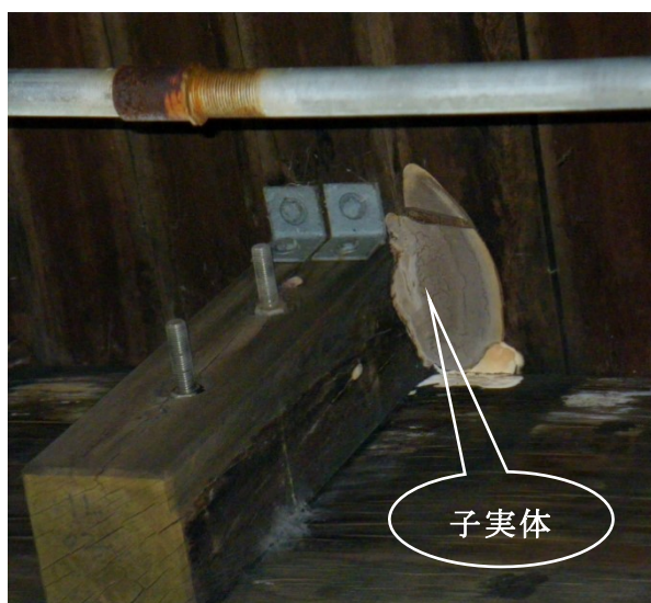
写真 2.2.6 木材腐朽菌の子実体の事例
